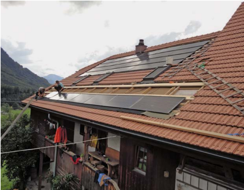
2010 wird eine Photovoltaikanlage installiert (Foto: Heidi Wendler)
