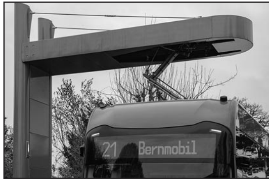
Dieser Ladearm lädt den Elektrobuss an der Endstation im Nu.
