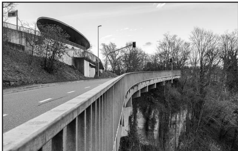
Im Zuge der Sanierungsarbeiten wird auch das Gelände ersetzt und an die heutigen Vorgaben angepasst.
